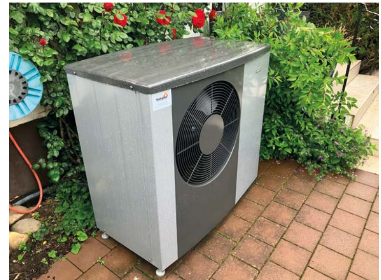
Auch bei diesem Anblick auf die sauber montierte Wärmepumpen-Infrastruktur bleiben keine Wünsche offen.
